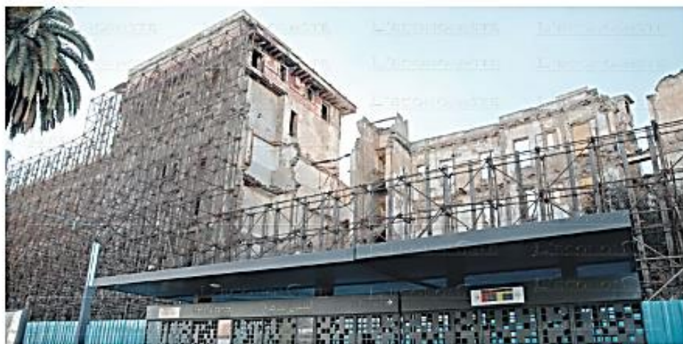
Dans la nuit du jeudi /vendredi 18 décembre, un pan de ce building s'est effondré non loin de la plateforme du tramway, au niveau de la station Marché central. Depuis la ligne 1 du tram est interrompue sur ce tronçon (Ph. F. Alnasser)
