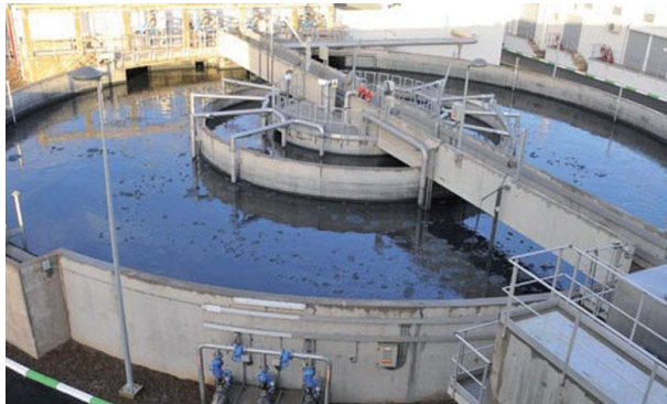
محطة معالجة المياه العادمة
